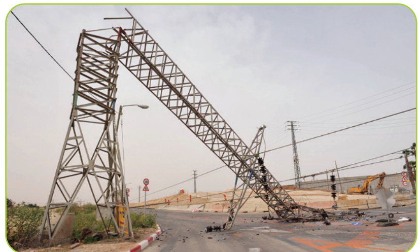
Fig. 4. Linie electrică afectată de furtună în Israel
