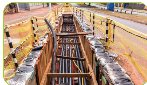
Fig. 5. Linie electrică subterană
