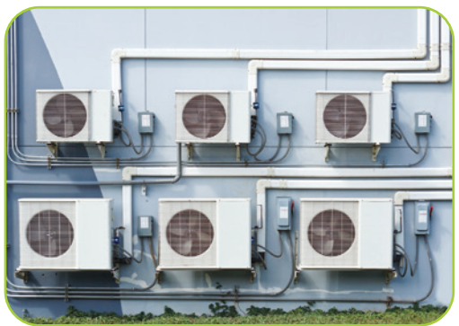
Fig. 12. Sistem de ventilație a aerului de mare capacitate
