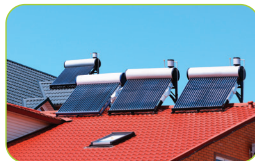
Fig. 3. Panouri solare termice
