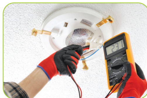
Fig. 4. Măsurări electrice realizate de persoane autorizate
